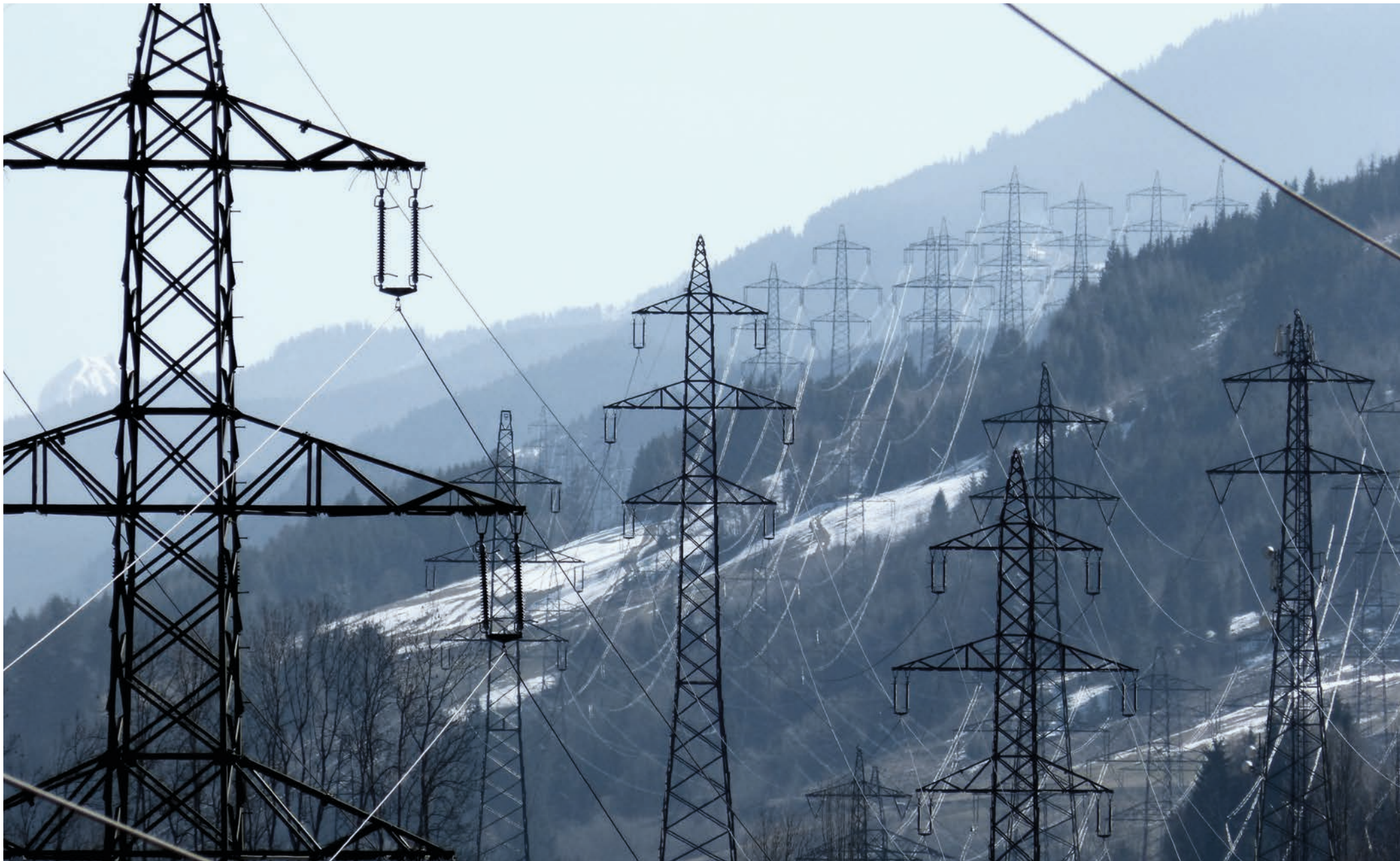
Abb. 2: Freileitungstrasse am Berg
